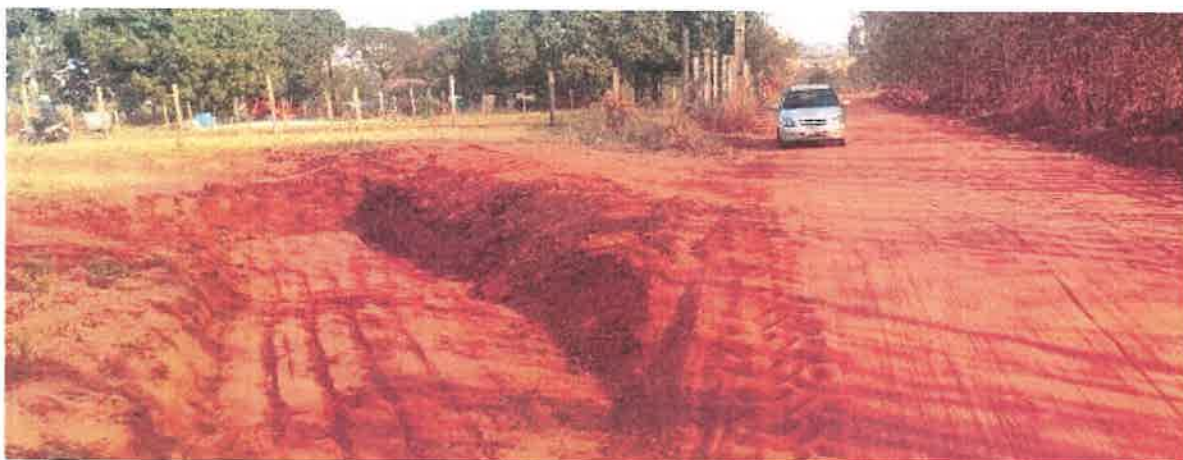
Imagem ilustrativa de caixa de drenagem em estrada rural
